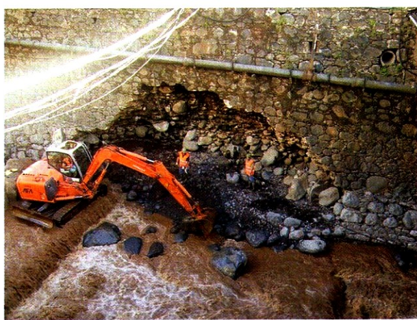
Foto 10 – Ruptura localizada, com origem na fundação – Muralha antiga da Ribeira de Santa Luzia – Funchal
