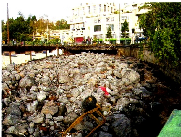
Foto 6 – Obstrução total da Ribeira de São João junto à foz, provocada pela carga sólida transportada pela ribeira
