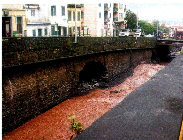
Foto 9 – Múltiplas rupturas localizadas, com origem na fundação – Muralha antiga da Ribeira de Santa Luzia – Funchal
