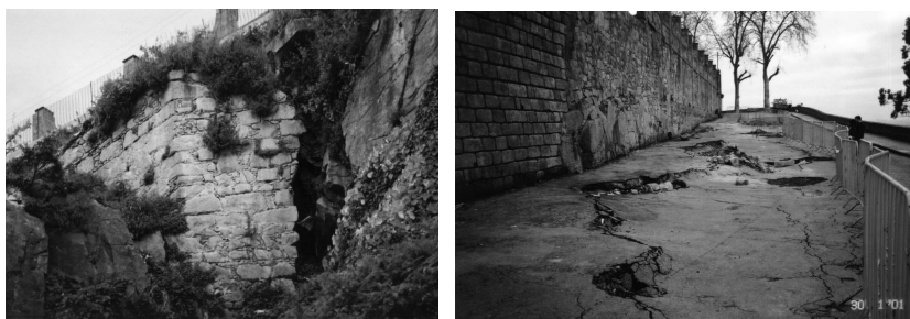
Figuras 1 e 2 – Abertura de fendas e movimento do muro na zona das Fontainhas
