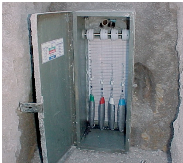
Figura 6: Conjunto de tell tales na caixa metálica
