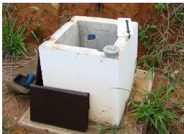
Figura 4 - Caixa de proteção e tampa do tubo de acesso do inclinômetro
