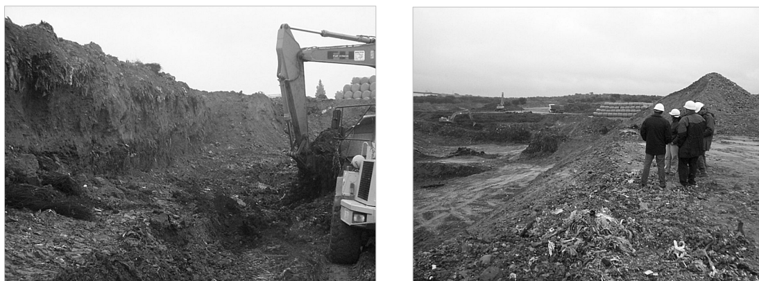
Figura 2 – Remoção dos resíduos em aterro na interface com os solos de fundação, e saneamento da fundação do aterro
