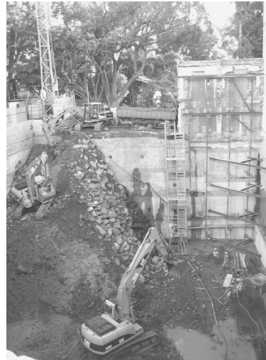
Figura 3 – Drenagem de águas subterrâneas em formações aluvionares numa escavação na Rua do Conselheiro José Silvestre Ribeiro, junto ao Jardim Municipal. © João Baptista, 2005
