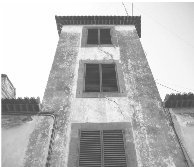
Figura 8 – Ocorrência de fendas que afectam a parede e a pedra que envolve as janelas da torre Avista Navios do Posto Emissor do Funchal, na Rua de São Lázaro, nº 3. © João Baptista, 2005
