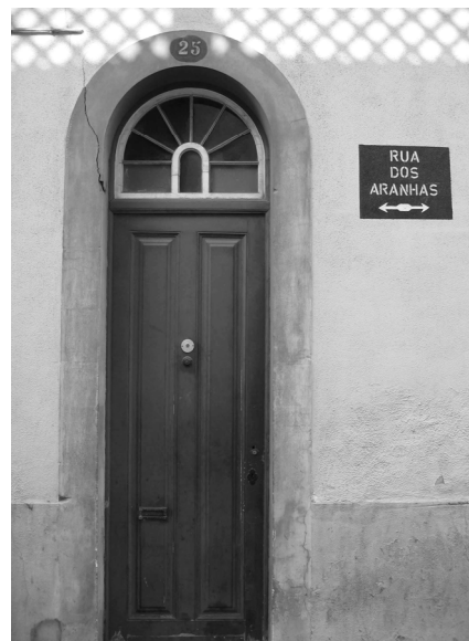
Figura 9 – Ocorrência de fenda que afecta a lumieira da porta de um prédio localizado na Rua dos Aranhas, nº 25. © João Baptista, 2005
